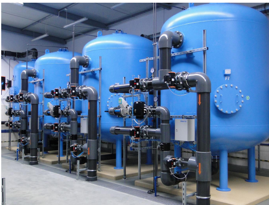
Fot. 1 Stacja uzdatniania wody średniej wielkości
